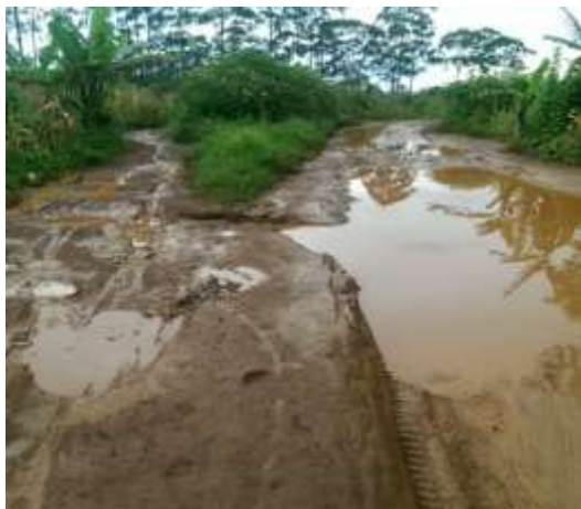
Figure 8. État de route dans le village Balessing.
